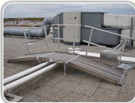
Rampe d'accès avec 1 garde corps pour transport matériels au dessous de conduit
